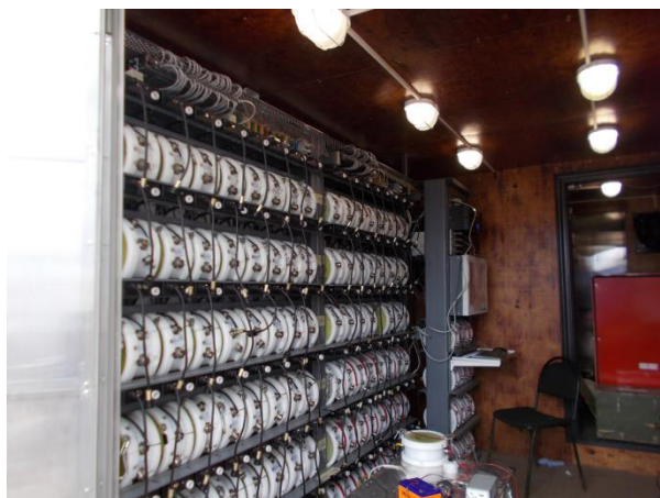
Рисунок 3. Стойка для обслуживания станций.
